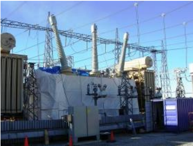
LFH Trocknung eines 750MVA/500 kV Autotransformators (Bild ABB)
