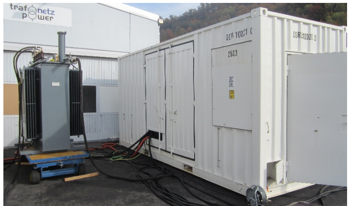
Unsere LFH Anlage angeschlossen an einem 2 MVA Transformator
