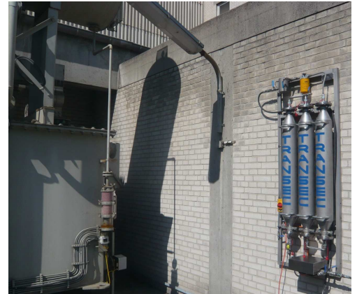
TRANSEC CL3 installiert an einem Gleichrichtertransformator
